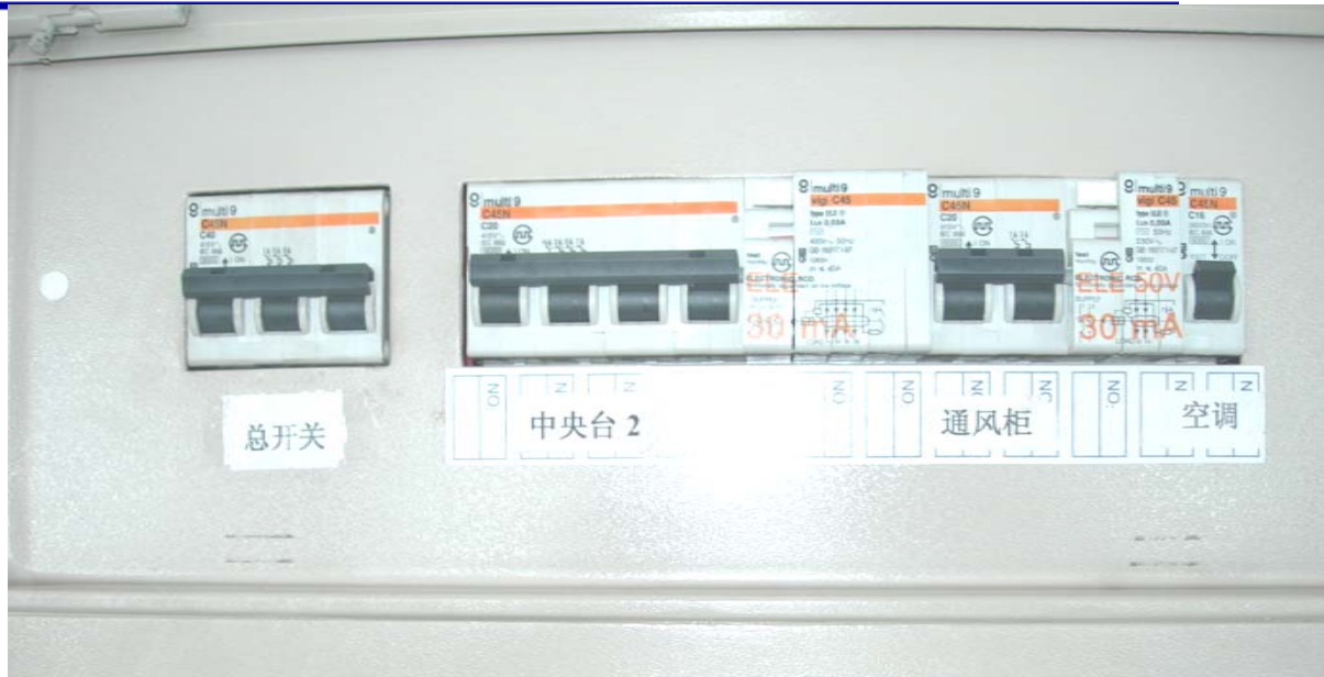
D区配电箱
