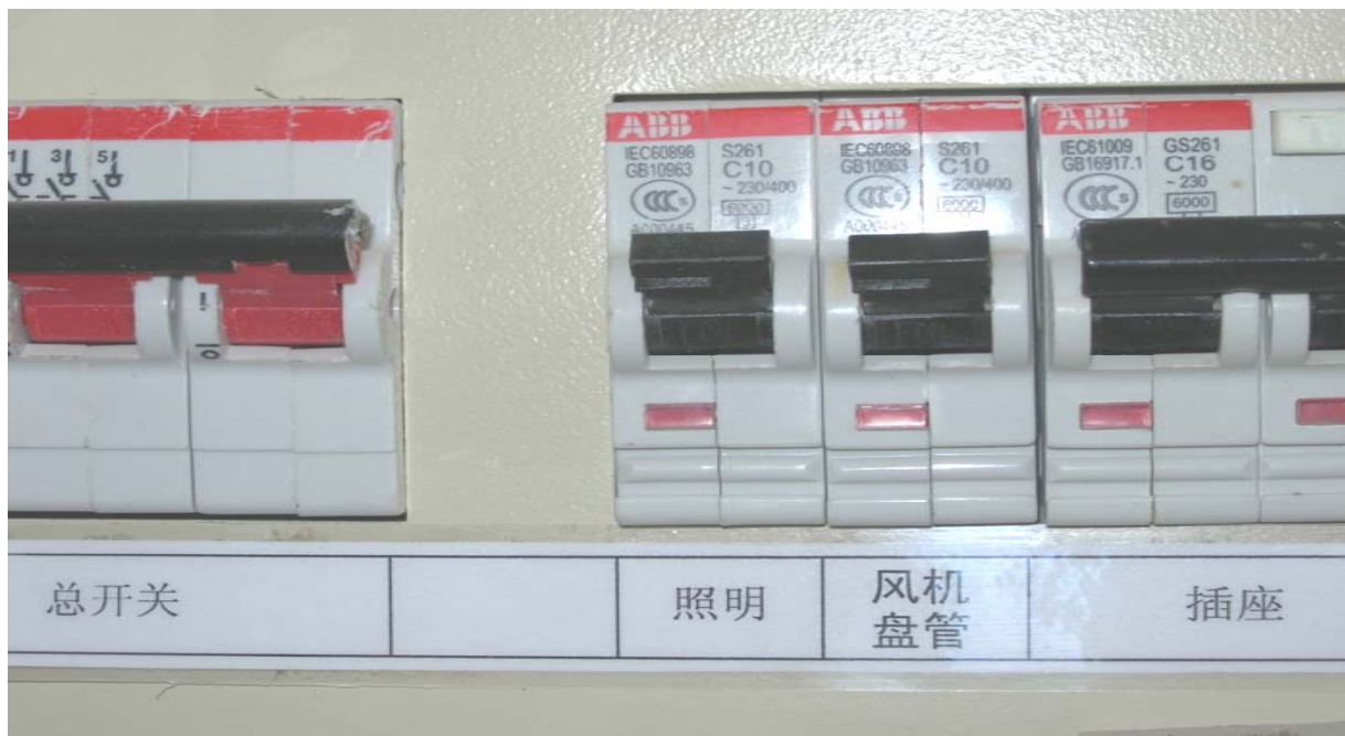
A区配电箱
